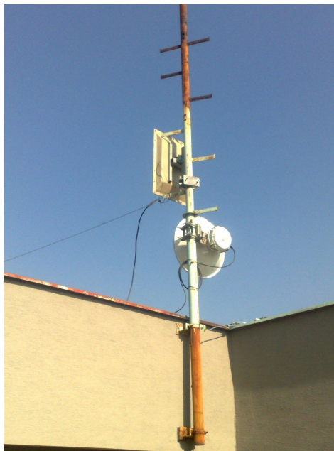
Obr. 4 – Parabola rádioreleového spoja na budove VÚS
